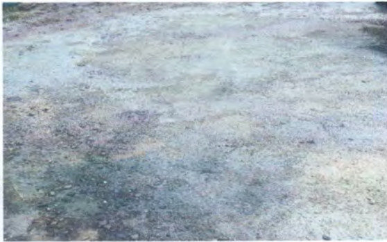
foto 9 : torta de concreto en la parte de adentro de la cocina
