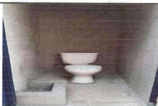
Foto 4: BAÑO EN MAL ESTADO
