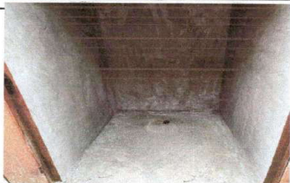
Foto 3: REPELLO DE PAREDES, CAMBIO DE ARTEFACTO SANITARIO
