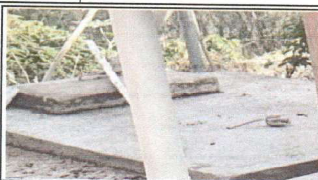
Foto 2: Caja de Registro
