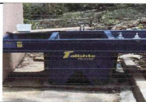
Foto 6: pila plastica mas base de concreto
