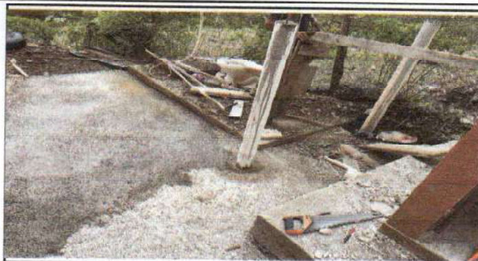
Foto 2: Caja de Registro
