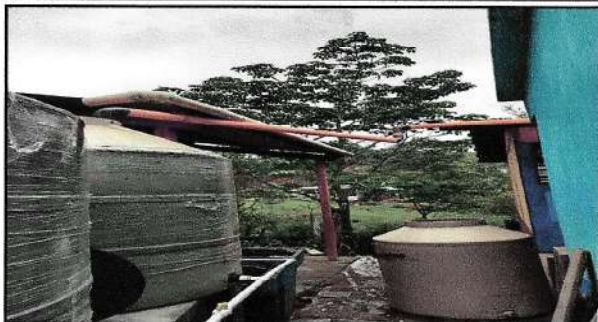
Foto 7: Bajadas de agua plubial
