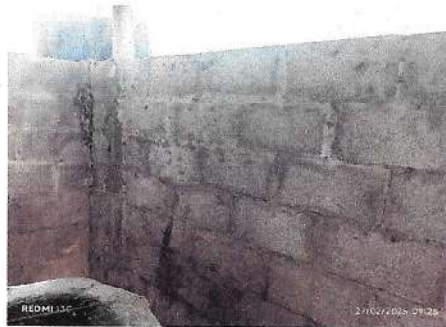
Foto 4: Seguimiento de muro en cocina
