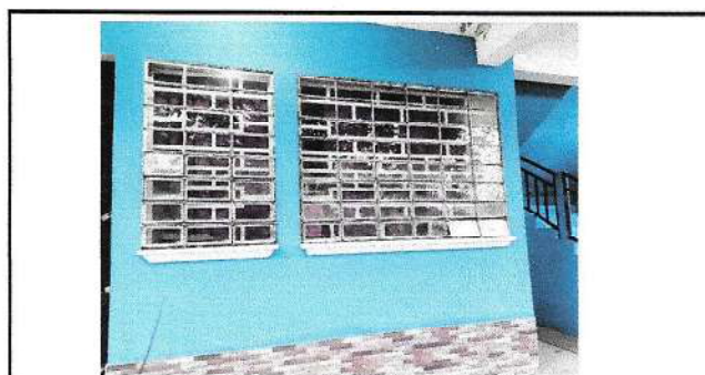
Foto 4: Balcón de Seguridad y Ventana
