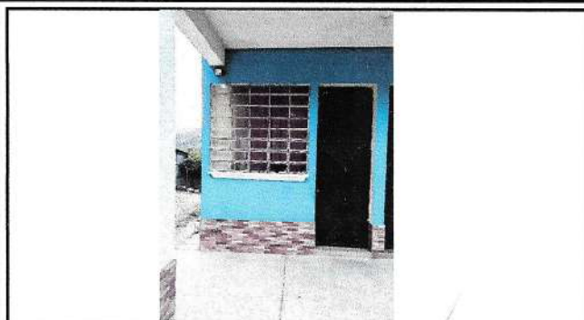
Foto1: Balcón de Seguridad y Ventana
