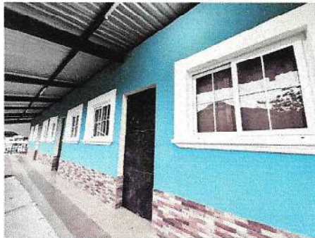
Foto 8: Balcón de Seguridad y Ventana
