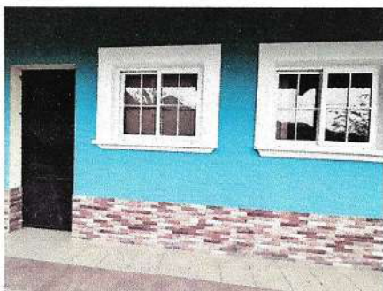
Foto 7: Balcón de Seguridad y Ventana
