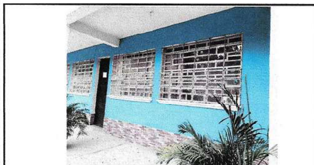
Foto 3: Balcón de Seguridad y Ventana
