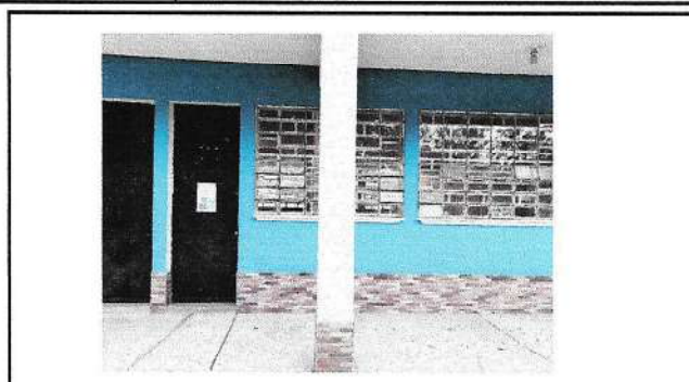
Foto 2: Balcón de Seguridad y Ventana
