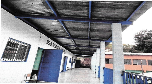
Foto1: ESTRUCTURA DE TECHO EN MAL ESTADO
