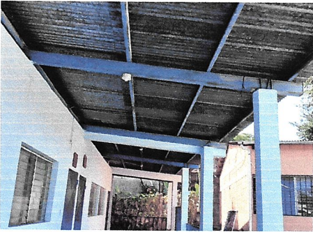
Foto1: ESTRUCTURA DE TECHO EN MAL ESTADO
