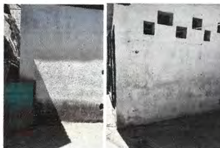
Foto 6: reparación de muro perimetral, paredes en mal estado se mueven y es un peligro existente por los sismos
