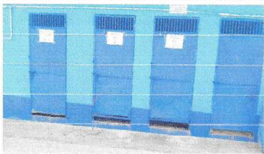
Foto 1: PUERTAS DE BAÑOS EN MAL ESTADO
