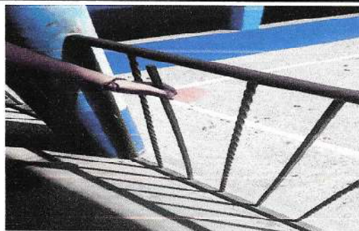
Foto 2: BARANDAS METÁLICAS EN MAL ESTADO
