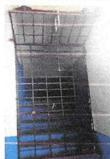
Foto 4: PUERTA EN MAL ESTADO
