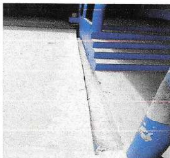
Foto 5: CUNETA SIN REJILLA
