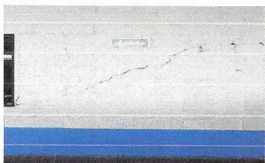
Foto 3: SECCION DE PARED EN MAL ESTADO
