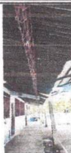
ESTRUCTURA DE TECHO EN MAL ESTADO
