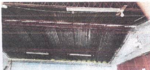
LAMINA EXISTENTE SE ENCUENTRA EN MAL ESTADO
