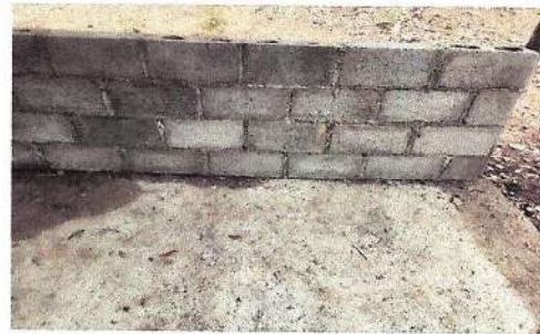
Foto 4: PARED Y PISO
