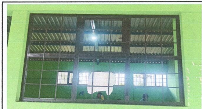
Foto 7: Falta vidrios en el primer salon del segundo nivel.
