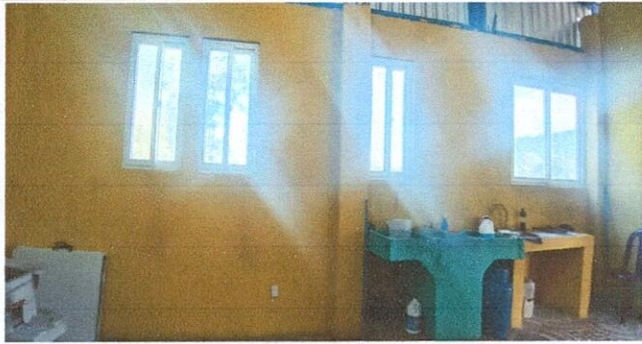
Foto 1: Falta de azulejo en la pared, 3 valcones en ventanas .
