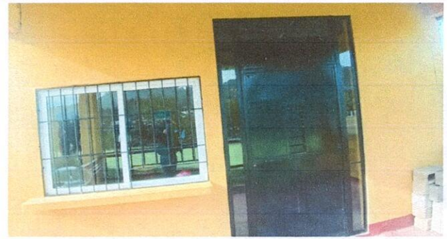
Foto 2: Falta de metal alrededor para asegurar la puerta
