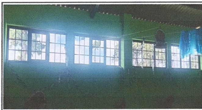
Foto 9: Falta de vidrios del tercer en el segundo nivel
