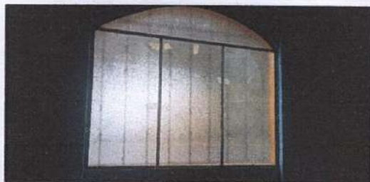
Foto 5: Mejoramiento de ventana, ( no tiene ventilación, esta sellada)
