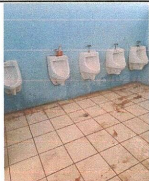
Foto 1: SERVICIOS SANITARIOS Y SUS ACCESORIOS. Por el deterioro de los años, se sale el agua porque algunos baños están quebrados, aunque se arreglen las mangueras, el agua sigue saliendo.
