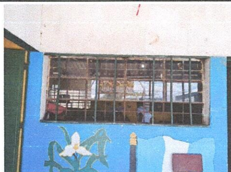
Foto 10: mantenimiento de barandas por deterioro
