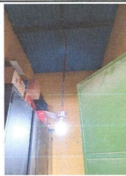
Foto 8: se necesita mantenimiento de techo y tendido electrico.
