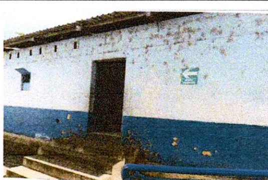
Foto 2: MANTENIMIENTO CORRECTIVO DEL AREA DE COCINA YA QUE LA ENTRADA ES PELIGROSA CUANDO SE LAVA.
