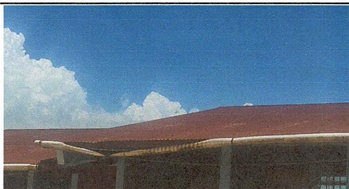
Foto 3: Las láminas del techo están mal posicionadas respecto a los canales de desagüe, lo que impide un drenaje eficiente del agua. Además, el deterioro visible de las láminas agrava el problema de filtraciones.
