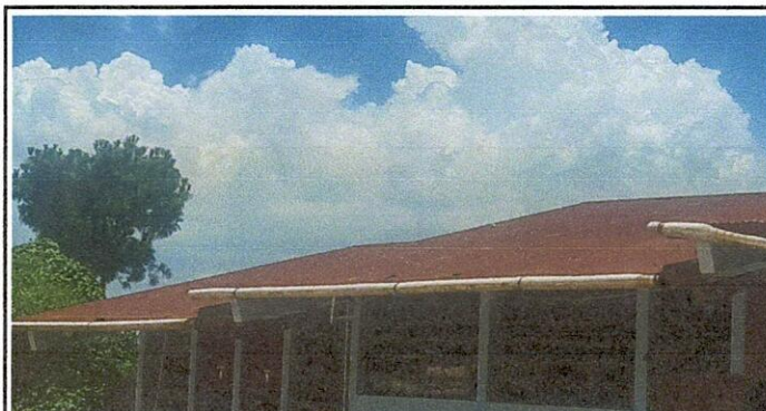
Foto 4: Las láminas actuales del techo muestran un deterioro considerable debido al paso del tiempo, lo que ha comprometido su funcionalidad y ha generado filtraciones. Por lo tanto, se solicita su sustitución inmediata.
