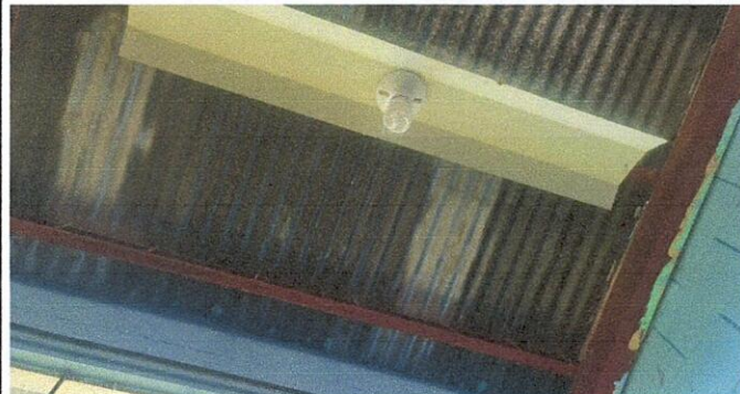
Foto 2: Por el deterioro el techo actual, se filtra agua al interior de las aulas durante las lluvias, lo que afecta el uso adecuado del espacio.
