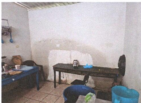
Foto 3: hay filtración de agua en pared de cocina
