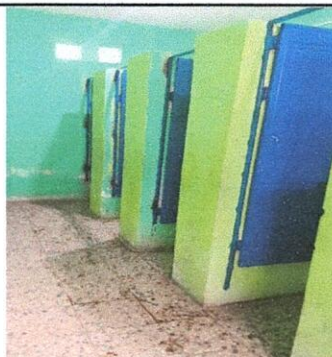
Foto 4: puertas en mal estado
