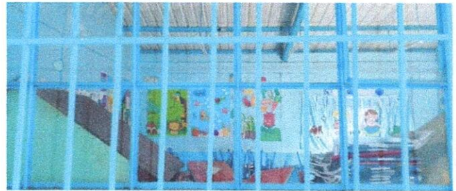
Foto 4: hay necesidad de hacer corredizas las las ventanas por poca ventilación en el aula
