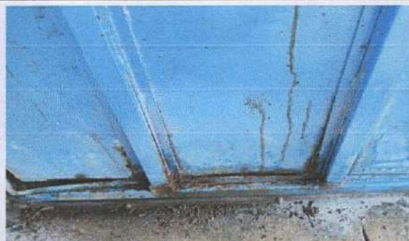
Foto 4: PIESAS OXIDADA DEL PORTON CAMBIO DE PORTON
