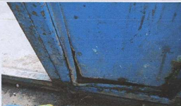
Foto 3: CAMBIO DE PORTON OXIDO TOTAL DE LAS PIESAS
