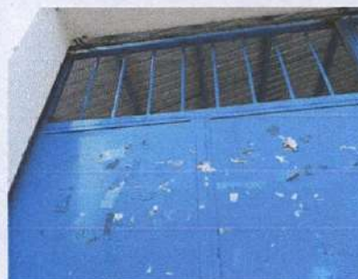
Foto 2: CAMBIO DE PORTON YA QUE NO CUENTA CON SEGURIDAD
