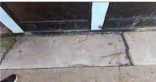
FOTO 11. REMOZAMIENTO DE TORTA DE CEMENTO FRENTE A LOS SANITARIOS
