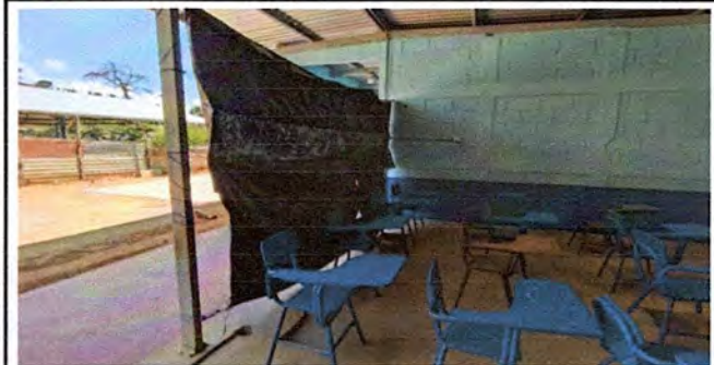
Foto 6: falta de pared frontal en la parte frontal del aula.
