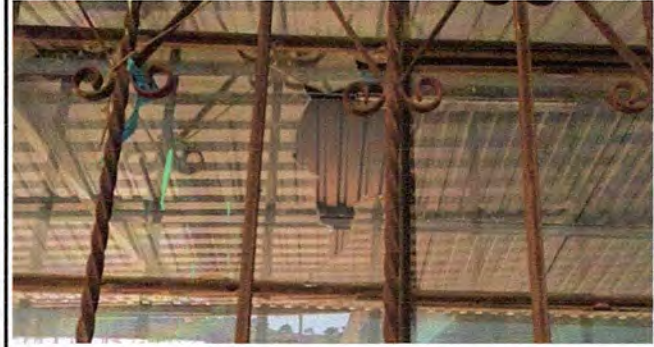
Foto 2: Vidrios en mal estado, representando una amenaza en catastrofes naturales.
