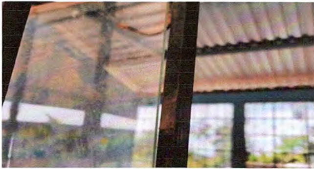
Foto 1: Inestabilidad en la unión de vidrios y estructura metálica por el paso del tiempo.
