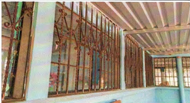
Foto 3: Ventanales, balcones y puertas en mal estado por la oxidación.
