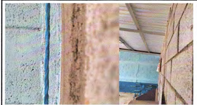
Foto 4: Desniveles en la pared, representando una amenaza creciente espuesta con grietas.
