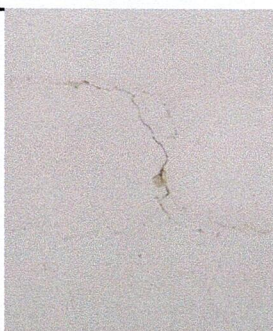
Foto 4: TERCERO A. Pared de aula con muchas rajaduras.
