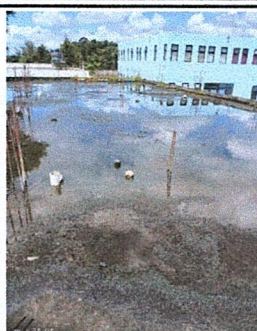
Foto 2: ALA B. Losa acumula agua y se filtra, se necesita habilitar pañuelos.
