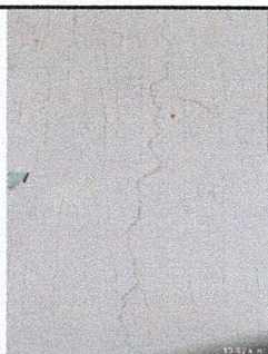
Foto 5: TERCERO A. Pared de aula con muchas rajaduras
