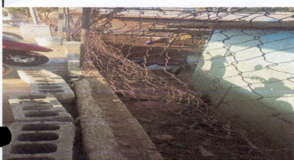
Foto 1: Pared inclonclusa y desaliniada. (área de trabajo)
