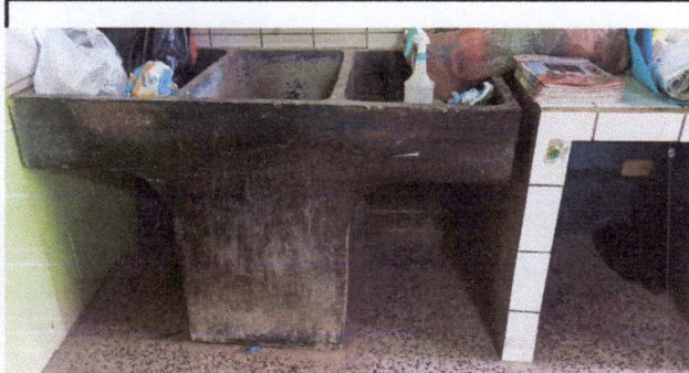
Foto 3: pila a sustituir.
