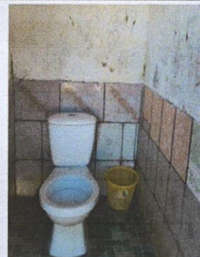
Foto 6: Paredes y pisos no adecuados, piso y azulejo en mal estado.
