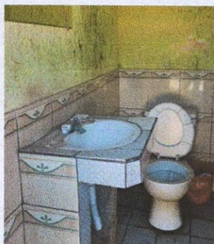
Foto 5: Servicios sanitarios en mal estado, pequeños y poco funcionales.
