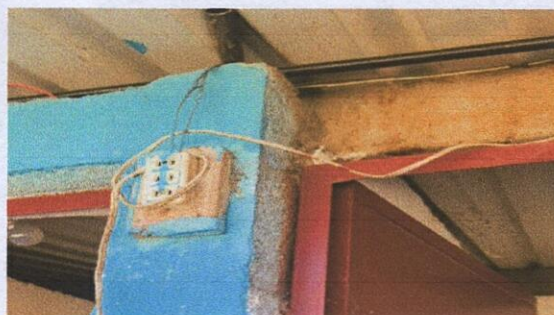
Foto 4: Sistema electrico en mal estado e inutilizable.
