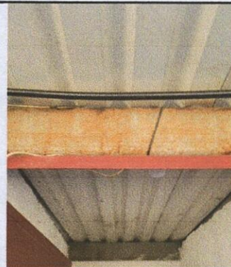
Foto 2: Costaneras y láminas en mal estado.
