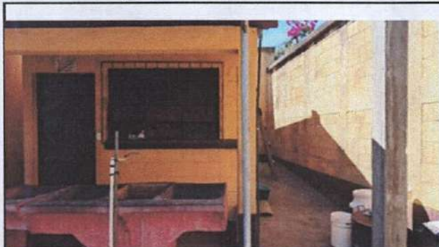
Foto 1: unión de pared del la derecho con la pared del lado izquierdo
