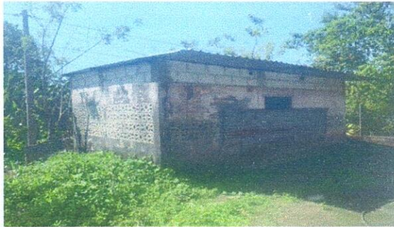
Foto1: Repello de cocina
