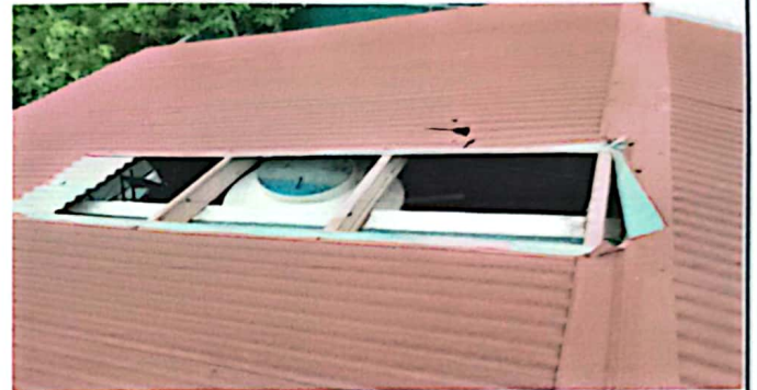
Foto 2: Baños de varones sin láminas y deteriorados.
