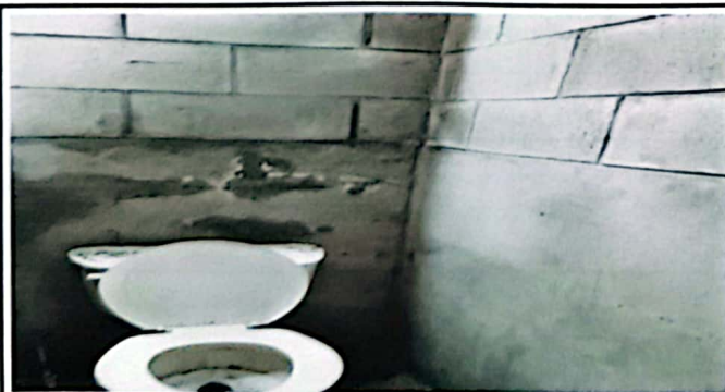
Foto 5: Baños de señoritas deteriorados.
