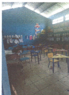
Foto 3: Introducción de electricidad, situación actual problemas de iluminación
