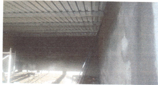
Foto 2: cernido de paredes.
