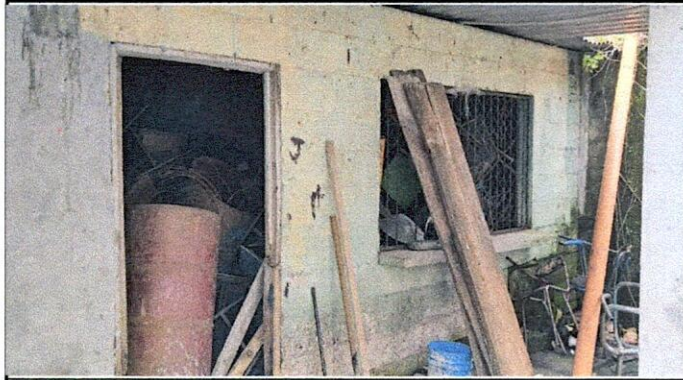
Lugar: Donde iría los sanitarios nuevos
