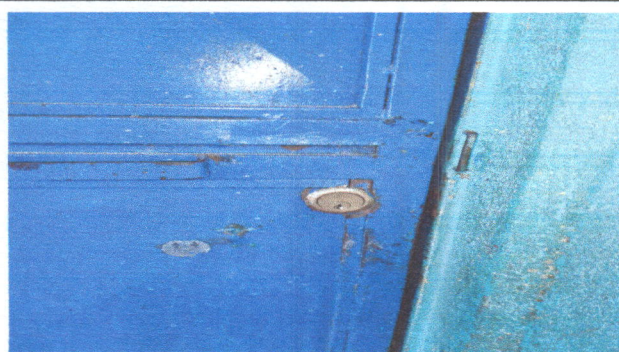
Foto 4: Situación actual de las puertas y chapa.
