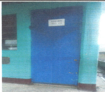
Foto 4: Situación actual de las puertas y chapa.
