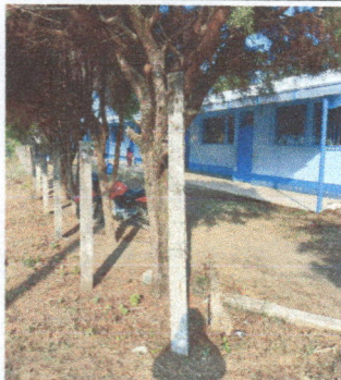
Foto1: Circulación en mal estado
