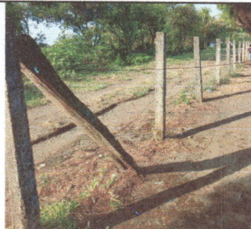
Foto 2: Deterioro de malla
