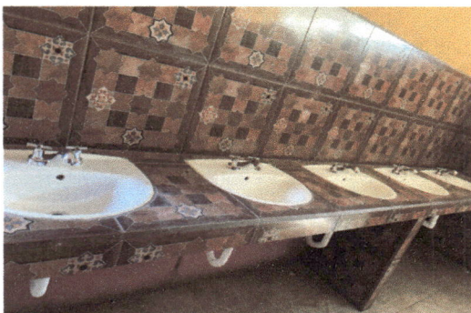
Foto 7: en la imagen se observa los lavamanos con los chorros nuevos correctamente instalados, se muestra ordenada, evidenciando que el trabajo fue concluido satisfactoriamente y que el lavamanos está en buenas condiciones para uso.
