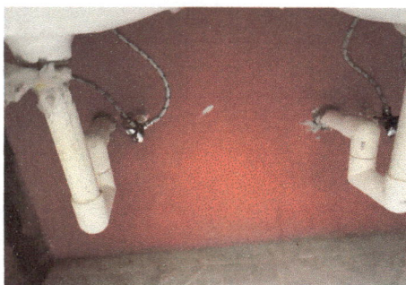
Foto 9: se ha detectado que los sifones de los lavamanos presentan deterioro y requieren revisión o reemplazo para asegurar su correcto funcionamiento
