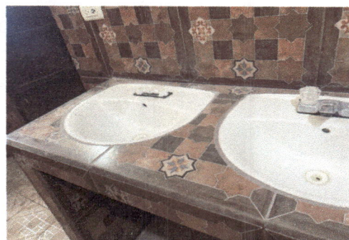
Foto 8: se ha detectado que los lavamanos presentan fallas y deterioro, por lo que requieren reparación para garantizar su correcto funcionamiento
