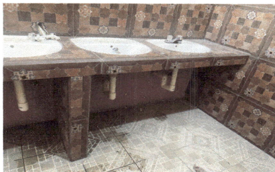
Foto 14: Los lavamanos no se encuentran funcionando, se encuentran en mal estado
