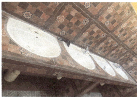
Foto 15: los lavamanos presentan deterioro y carecen de las llaves de los chorros, lo que impide su correcto funcionamiento y requiere reparación o reemplazo
