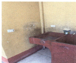
Foto 2: la pintura de la cocina se encuentra en mal estado y requiere ser renovada para mejorar la higiene y apariencia del espacio
