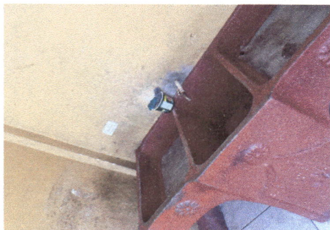
Foto 7: se requiere la colocación de azulejos en la pared del área de la pila, ya que actualmente se encuentra muy sucia
