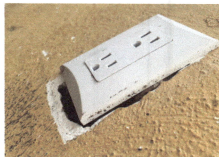
Foto 10: los tomacorrientes presentan deterioro y requieren revisión o reemplazo para garantizar su correcto funcionamiento y seguridad
