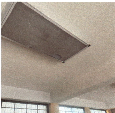
Foto 13: La fotografía muestra una lámpara dañada
