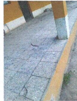
Foto 2: Piso en mal estado
