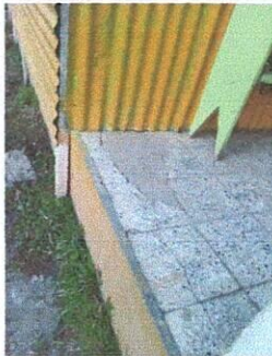
Foto 3: Piso en mal estado
