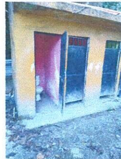
Foto 4: Pintura actual de sanitario
