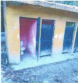
Foto 1: Sanitarios en mal estado
