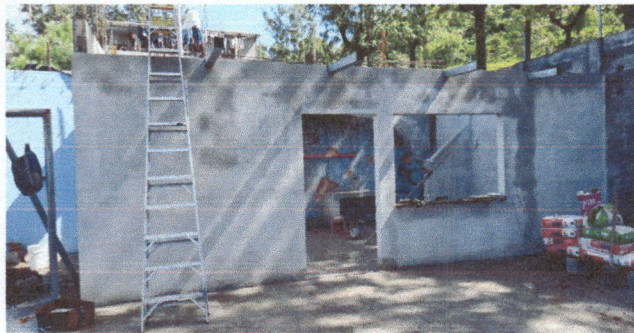
Vista actual del repello de la cocina
