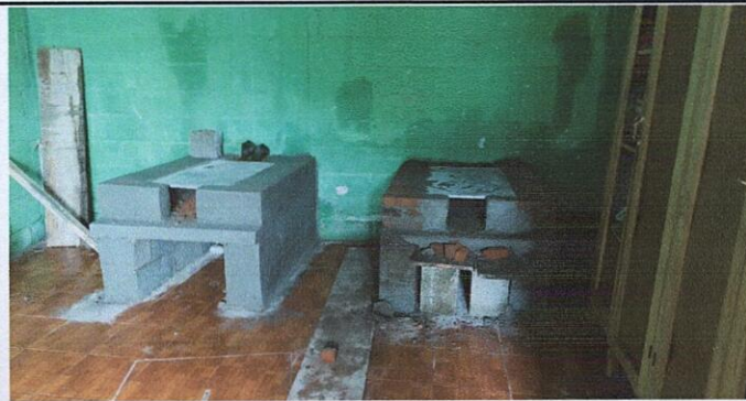
Foto 2: paredes en mal estado
