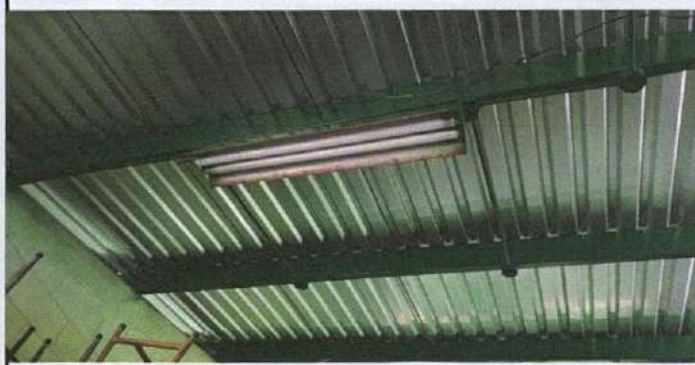
Sistema eléctrico todo el edificio
