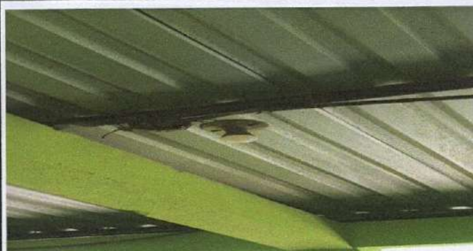
Sistema eléctrico área de preprimaria
