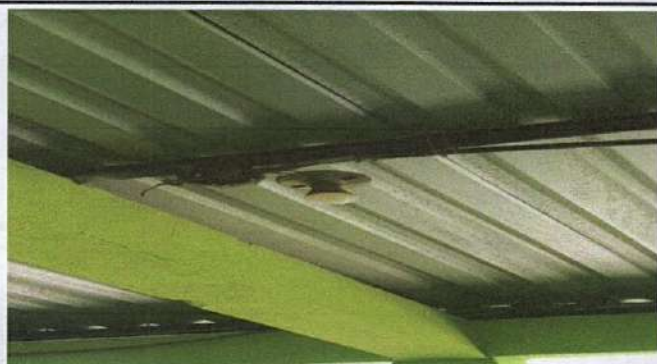
Sistema eléctrico todo el edificio
