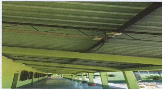
Lamparas y cableado de todo el edificio
