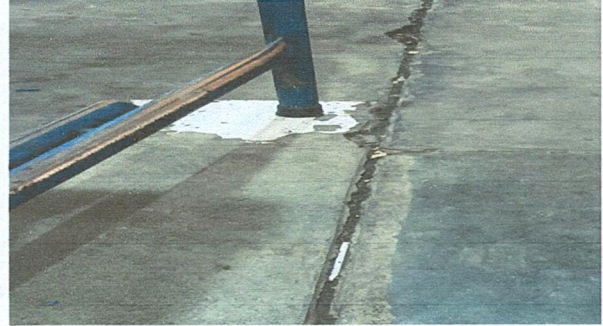
Foto 2: Piso de concreto deteriorado en el aula de Párvulos
