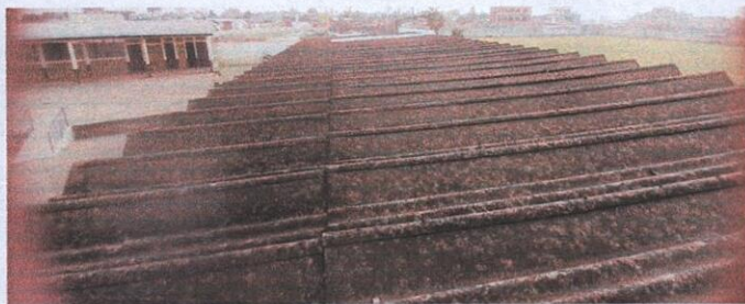
Foto 5: el techo ha perdido ya su tiempo de vida útil
