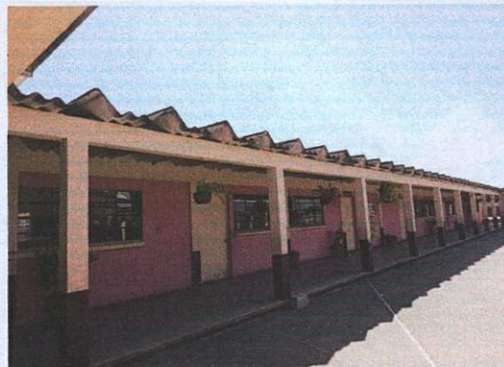
Foto 2: Se evidencia lámina de duralita en el patio de aulas y área de sanitarios
