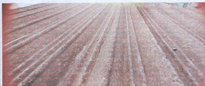
Foto 4: la lámina ya se encuentra deteriorada
