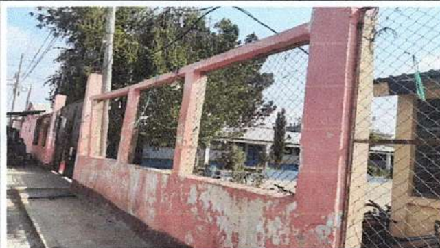
Foto 2: columnas se encuentran ya falsas que en cualquier momento pueden causar algún insidente en los niños.
