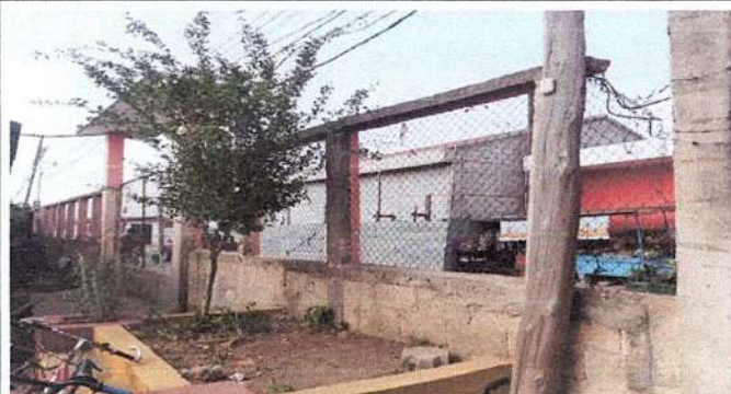
Foto 4: Malla en mal estado, sustitución por block.
