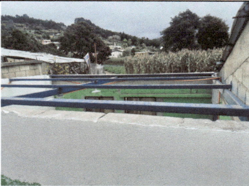
Foto 5: Techo del aula 2 ya sin láminas.
