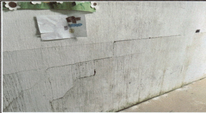
Foto 1: Grietas en la parte inferior de la pared (primer ambiente)
