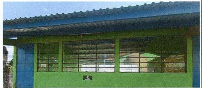
Foto 2: Protección de Ventanas a través de Balcones con hierro entorchado de 1/2 pulgada, Legítimo, Maraca HG, Con las medidas de 1.12 cm de altura por 2.38 cm de largo
