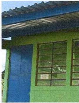
Foto1: Protección de Ventanas a través de Balcones con hierro entorchado de 1/2 pulgada, Legítimo, Maraca HG, Con las medidas de 1.12 cm de altura por 1.37 cm de largo
