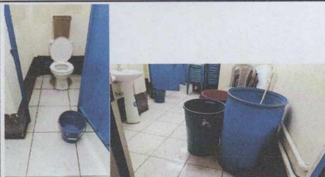
Foto 3: La tubería no es funcional: no se llena los depósitos de los baños y no llega el agua a los lavamanos.
