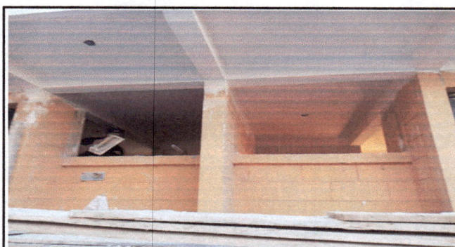
Foto 6: Repello de techo de baño.
