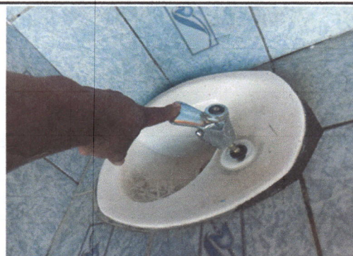
LAVAMANOS SIN FUNCIONAR
