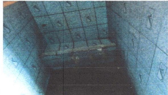
MIGITORIO EN MALAS CONDICIONES Y DRENAJE TAPADO
