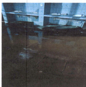
INUNDACION POR MALA TUBERIA
