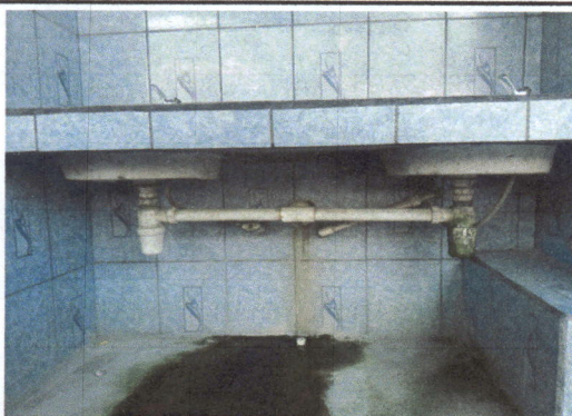
RED DE AGUA PARA LAVAMANOS NI PODER UTILIZAR POR FALTA DE ACCESORIOS
